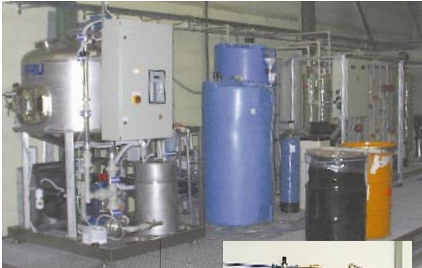
Bild 2: Vakuumverdampfer WSC-500. Die Anlage hat einen Durchsatz von 22 l/h.
