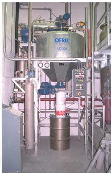
Bild: Destillationsanlage ASC-200 im EX-Raum
